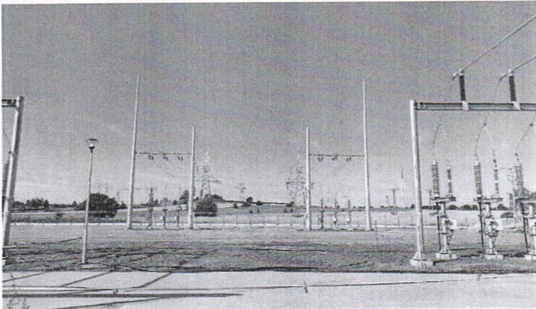
Zdjęcie nr 1. Stacja elektroenergetyczna SE 15/110 kV Grajewo 2 - widok na fragment obiektu.
