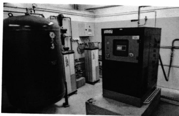
Zdjęcie 5 System sprężonego powietrza
