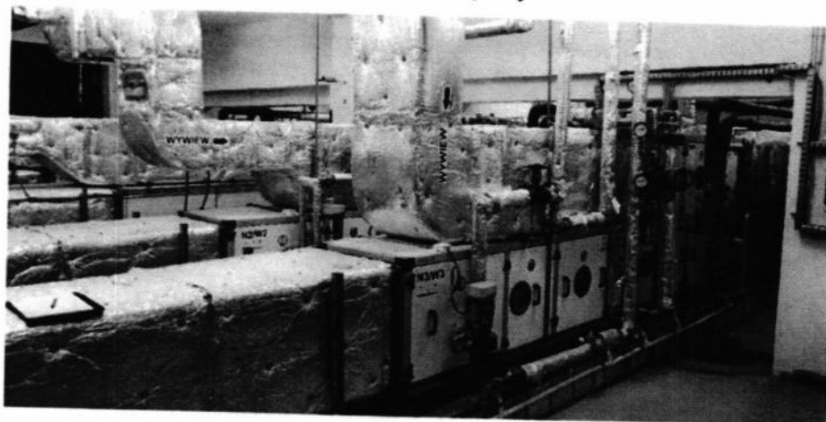
Zdjęcie 4 Centrale klimatu głównego systemu klimatyzacji
