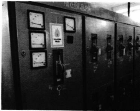
Zdjęcie 2 Rozdzielnia NN
